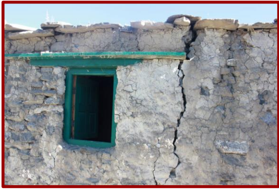
Foto 3: Schäden am Schulgebäude
